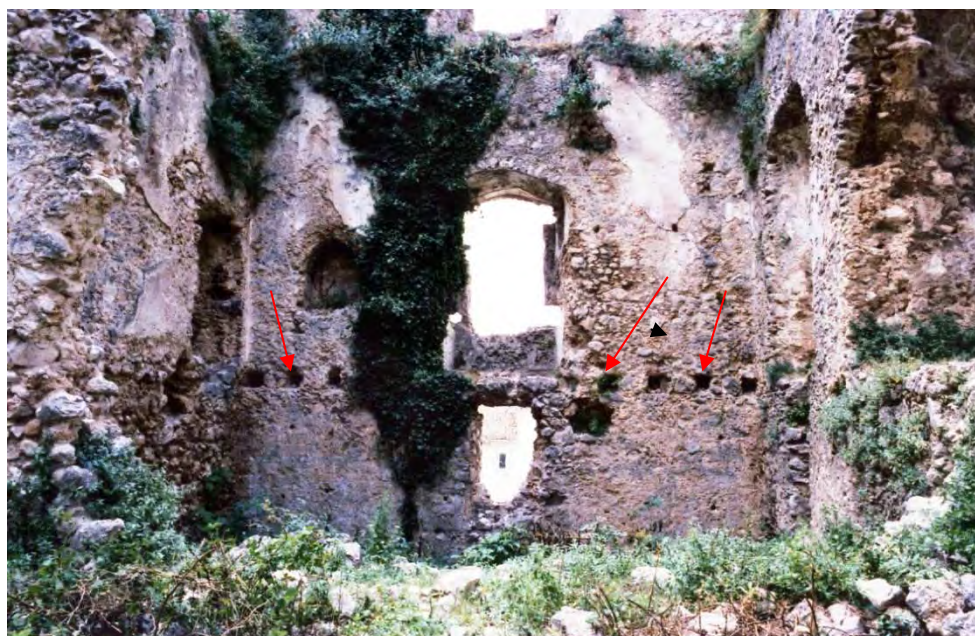
Figura 2 - In parete sono ben visibili gli alloggi delle travi in legno originarie della seconda orditura
