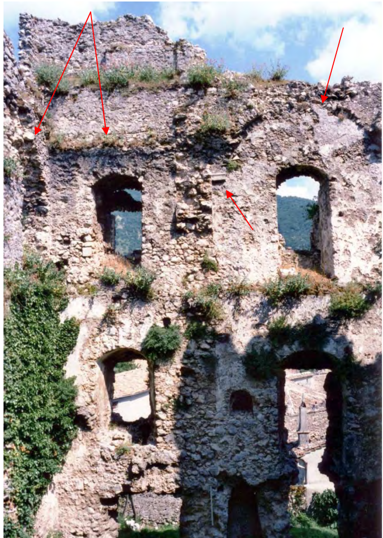
• Figura 1- L'immagine riporta il forte degrado del monumento ante operam. Al terzo livello è possibile notare le imposte delle volte di copertura e relative mensole in piperno, a sostegno dell'originaria copertura piana.
