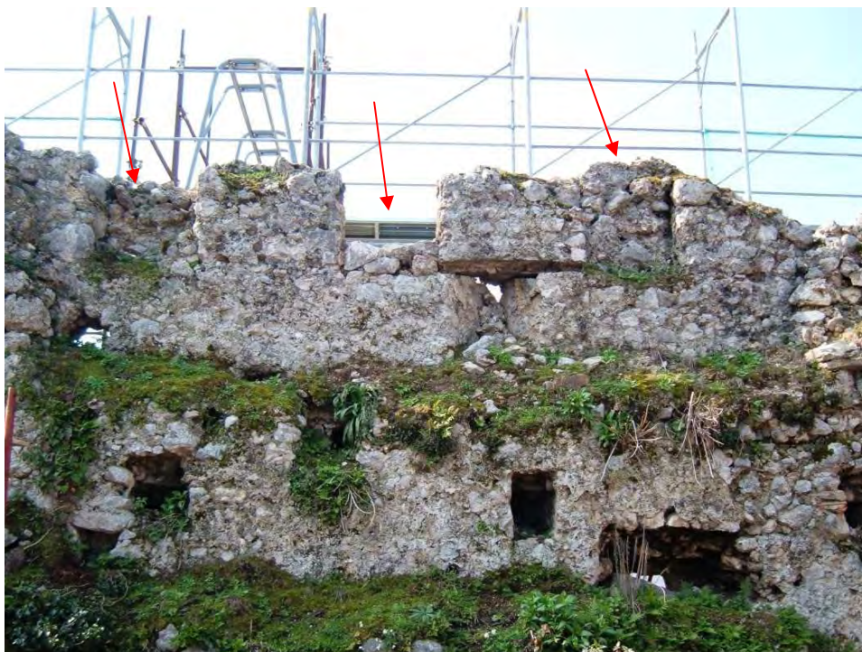
Figura 5 La merlatura sul lato meridionale murata da successivi interventi, quando, mutato il sistema difensivo, al loro posto sono subentrate feritoie e archibugiere.
